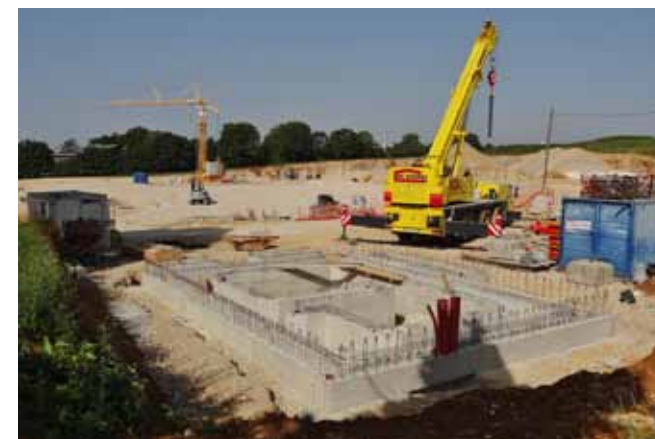
La sous-station électrique qui alimentera le centre et une partie de la ligne ; elle sera semi-enterrée et avec un toit végétalisé pour se fondre au maximum dans le paysage
