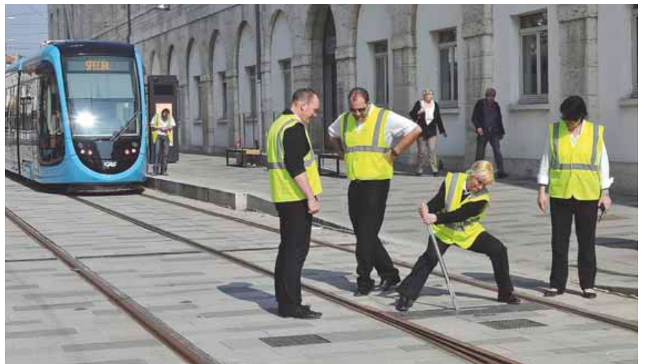
MODIFICATION MANUELLE DE L'AIGUILLAGE POUR PERMETTRE À LA RAME DE CHANGER DE VOIE. ↑
